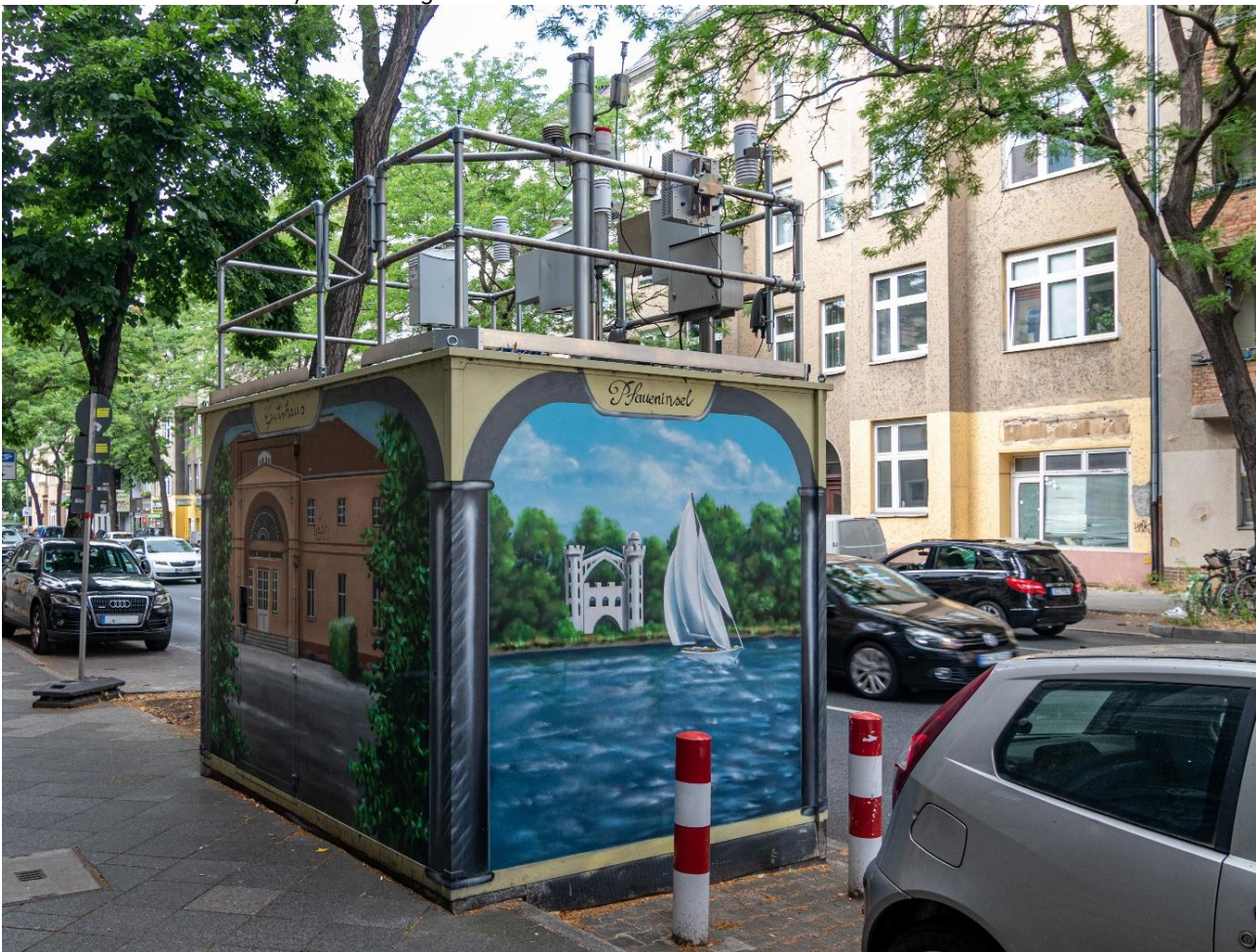
Abbildung 1: Messcontainer DEBE061 (MC117 Schildhornstraße) kurz vor dem Beginn der Vergleichsmessungen der ersten Projektphase am 30.06.2022.
