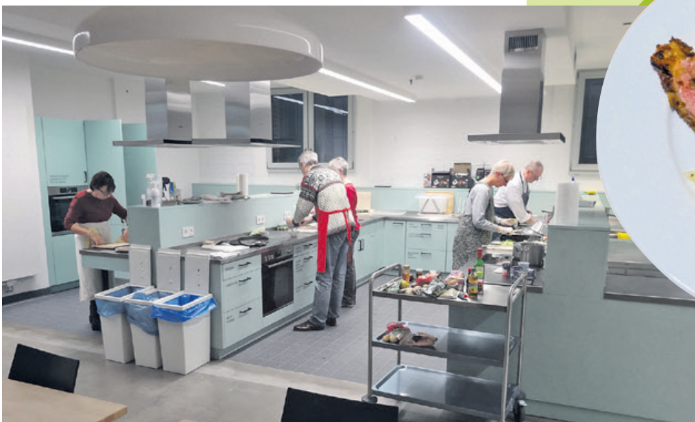
Die supermoderne Lehrküche der VHS mit leistungsstarker Küchentechnik, viel Platz zum Kochen, hellem Licht und bester Lüftung
