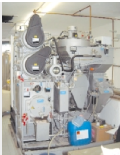
Neuanlagen müssen schon heute über eine Trommelluft-Konzentrationsmessung verfügen.
