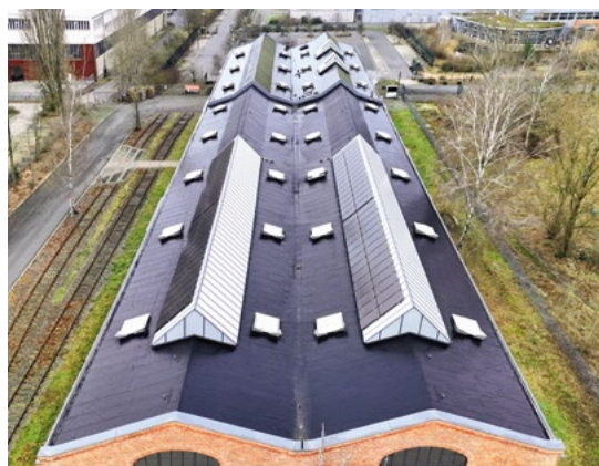
Abb. 30 | erste PV-Anlage auf den Lichtbändern 2015 /23/
