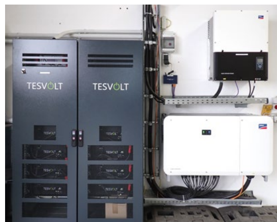
Abb. 28 | Stromspeicher und Wechselrichter /22/
