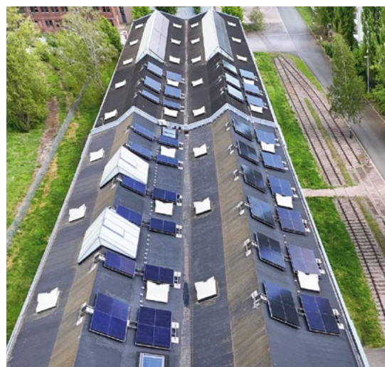
Abb. 31 | erweiterte PV-Anlage auf dem Dach 2024 /24/
