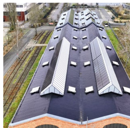
Abb. 6 | Photovoltaikanlage auf den Lichtbändern der denkmalgeschützten Kanonenhalle /4/ siehe Kapitel 7 - S. 29
