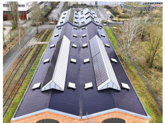
Abb. 31 | erste PV-Anlage auf den Lichtbändern 2015 /24/
