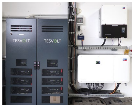
Abb. 29 | Stromspeicher und Wechselrichter /23/
