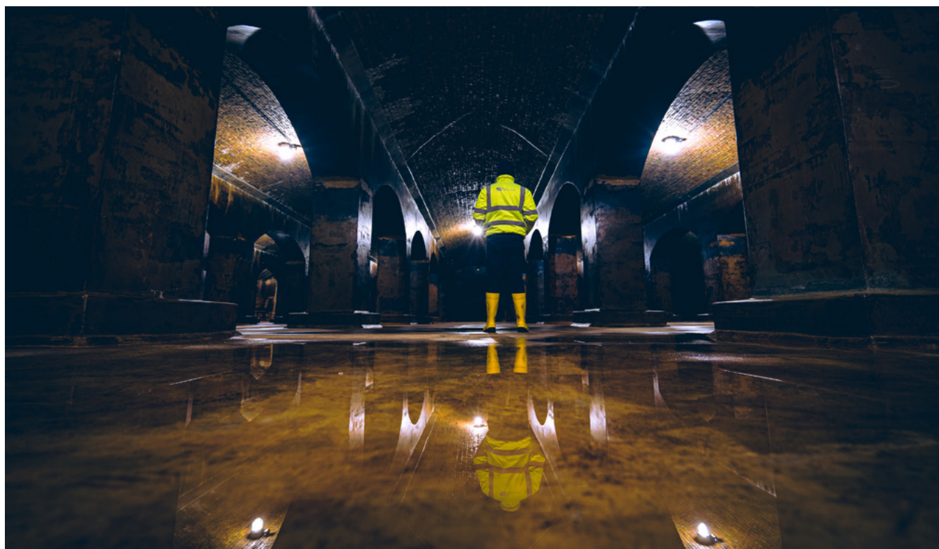
Reinwasserbehälter Wasserwerk; © Berliner Wasserbetriebe
