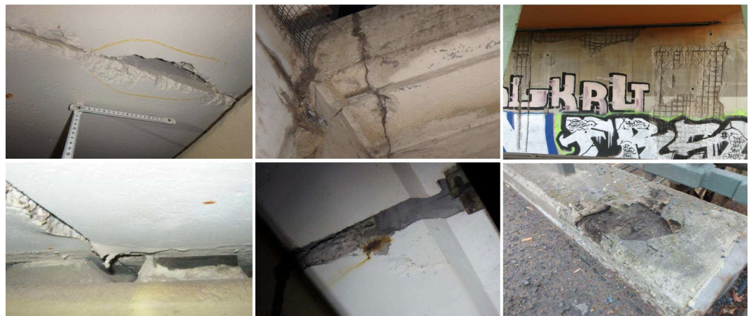
Abb. 8 - Typische Schadensbilder an Brückenbauwerken, z. B. Spannbetonbrücken, Bild: SenMVKU
