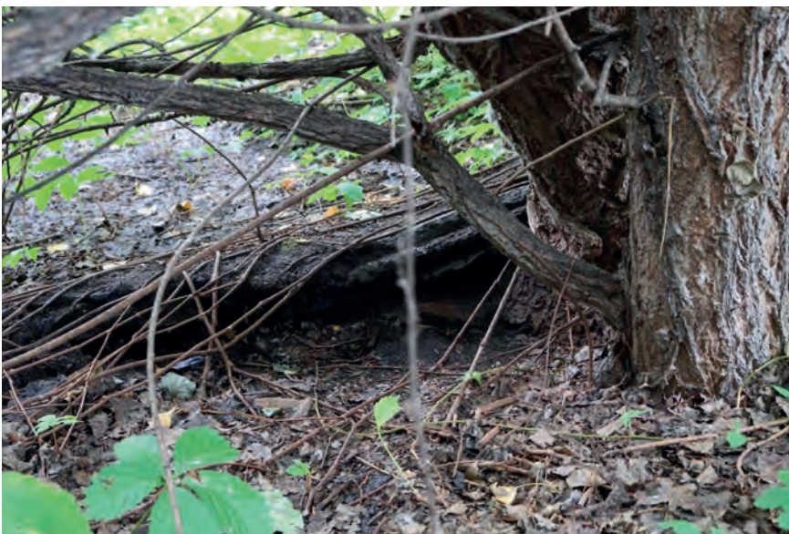
Abb. 25: Asphaltierung der Grenzübergangsstelle, durch Baumwuchs angehoben auf der Gemeinbedarfsfläche (Quelle: Stiftung Berliner Mauer, 2025)
