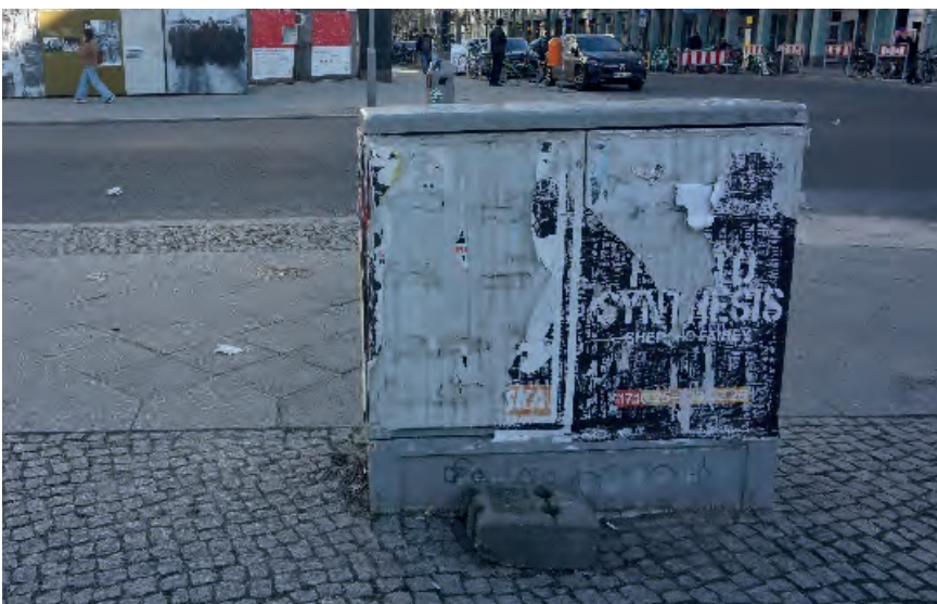
Abb. 66: Stromkasten Kreuzung Zimmerstraße / Friedrichstraße (Quelle: ISR, 2026)
