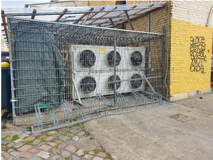
Abbildung 13: Rückkühlgeräte hinter dem LPG-Markt 29
