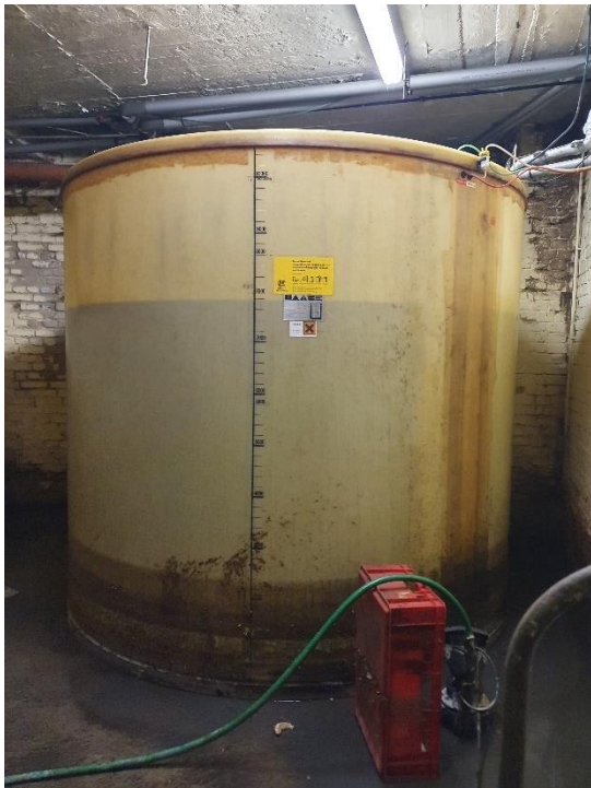
Abbildung 14: Öltank für die Wärmeversorgung des Gebiets der Phase I 30
