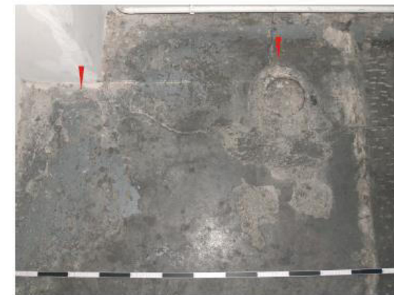
Abb. 12: Detailaufnahme von den beiden nachgerüsteten Toilettenstandorten. Ihre Abwasserrohre (Pfeile) sowie die Holzübelpositionen zur Fixierung der Sanitärkeramik wurden nach Demontage mit Beton verschlossen. Die linear angeordneten Hackspuren am rechten Bildrand gehörten angeblich zu einem aufgemauerten Galerie-Podest, für das der Estrich zur besseren Haftung des Mörtels aufgeraut wurde.
