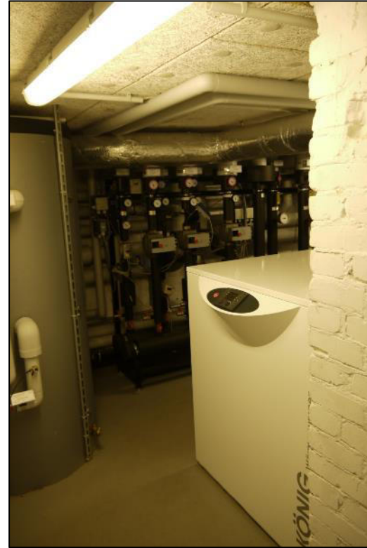
Energiezentrale und Wärmepumpe
