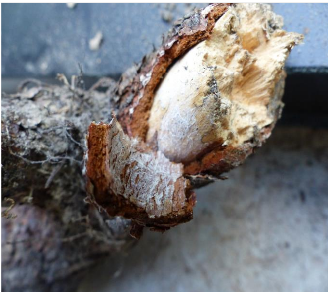
Abbildung 1: Weißfäule an einer Konifere, verursacht durch Hallimaschbefall
