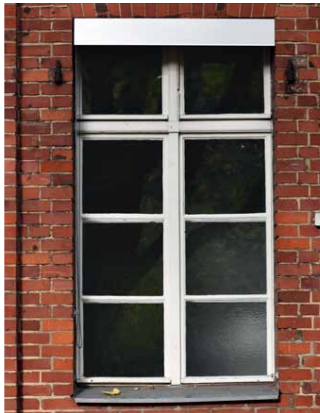
Berlin, Turmstraße 21 Hinweis: Keine denkmalverträgliche Lösung
