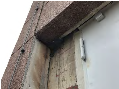
Tor mit Spalt zwischen Innen- und Außenwand (Westseite)
