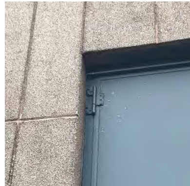
Tor mit Spalt zwischen Innen- und Außenwand (Ostseite)
