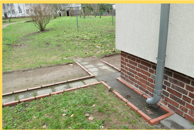
Regenwasser-Abkopplung von Dachflächen und Überleitung in Grünanlage | © Lp+b Berlin
