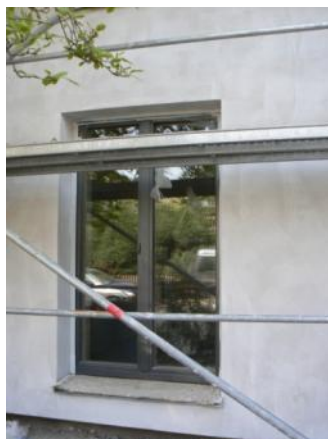
Abbildung A12: Einbausituation Fenstertüre nach Dämmung der Gebäudehülle
