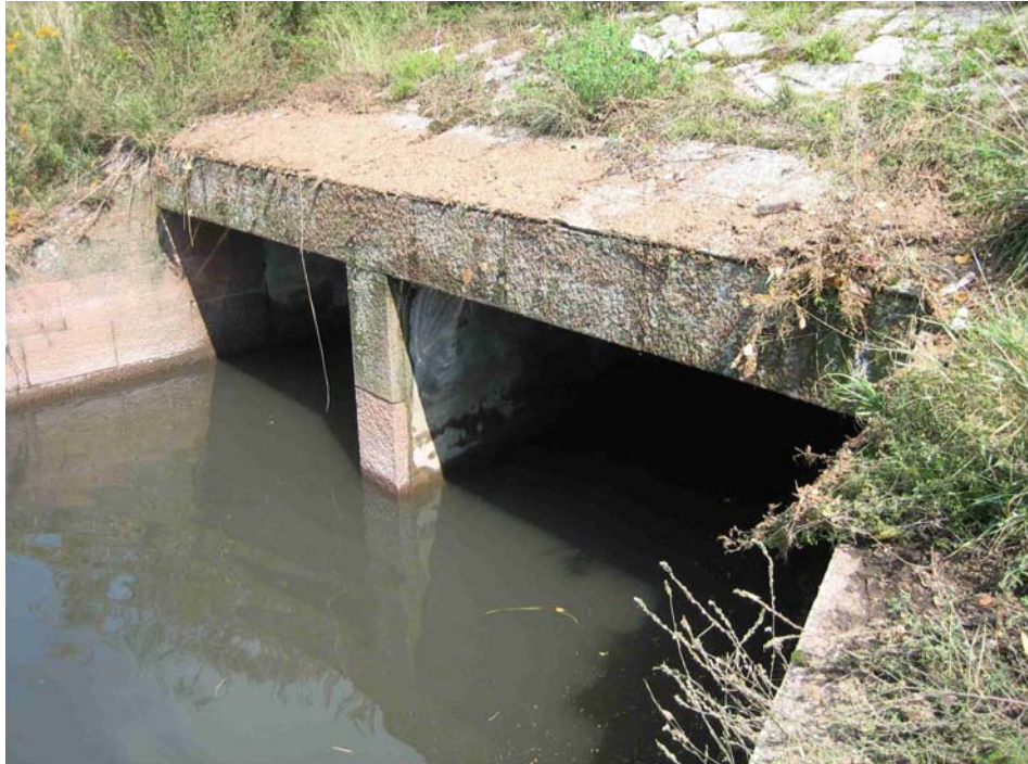
Abb. 14: Wasserstand am Zu- bzw. Auslaufbauwerk Nahmitzer Damm / Motzener Straße am 24.8.2007 nach einem Starkregen und wiederhergestelltem Bauwerk
