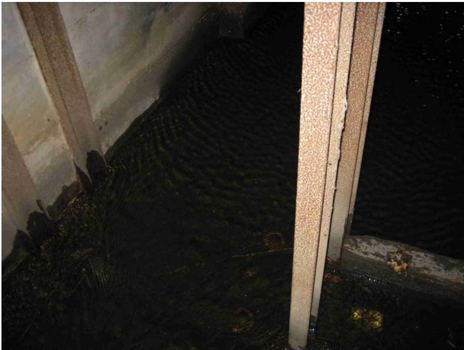
Abb. 13: Zustand an den Regulierungsbauwerken am 30.7.2007 im Zu- bzw. Auslaufbauwerk Nahmitzer Damm / Motzener Straße (fehlende Staubalken auf der linken Seite)
