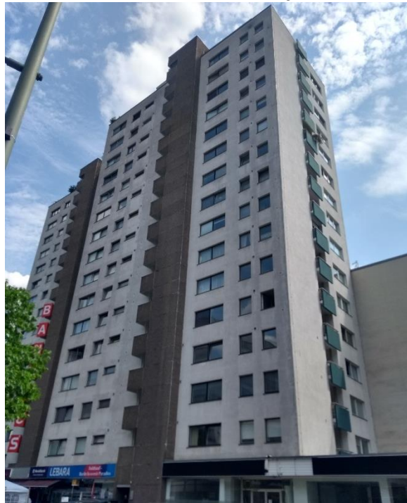
Abbildung 26: Gebäude mit nicht zeitgemäßer Fassadendämmung
