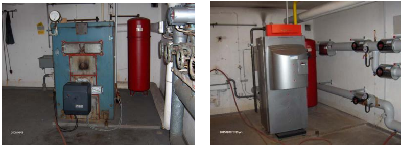
Abbildung 40: Umstellung von Öl auf Gas, Stadtteilbibliothek Lankwitz – Bruchwitzstraße 37
