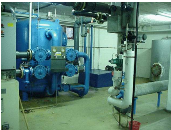
alter überdimensionierter Wasserfilter
