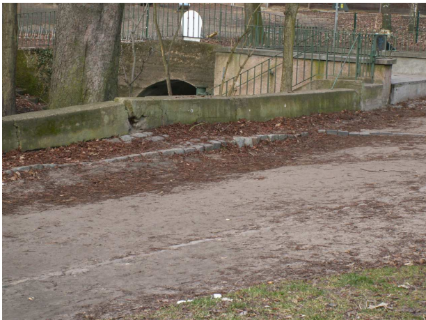
vor Baubeginn: Baumängel, wie schadhafte Wege und Ufer
