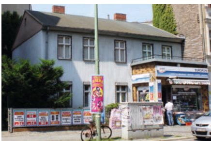
Fachwerk unter Blech versteckt, 1960 noch sichtbar (Pichelsdorfer Straße 127)
