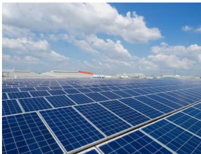
PV-Module auf Industriedach
