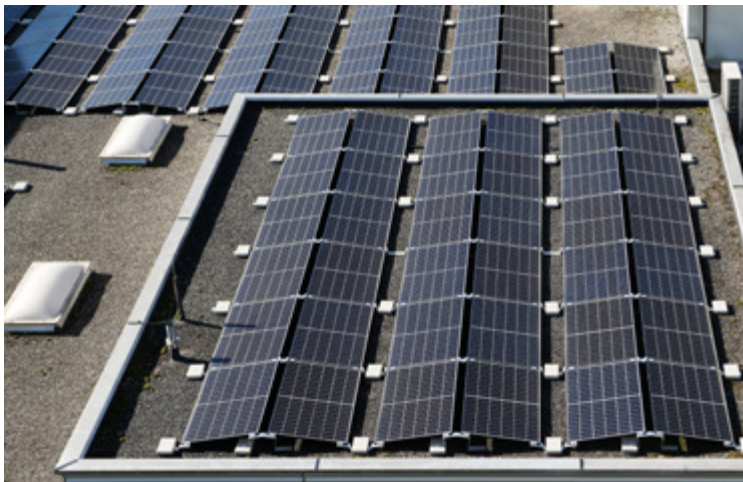
Abbildung 23 PV-Anlage auf Flachdach.
