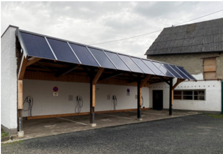
Abbildung 53 PV-Anlage auf einem Vordach.
