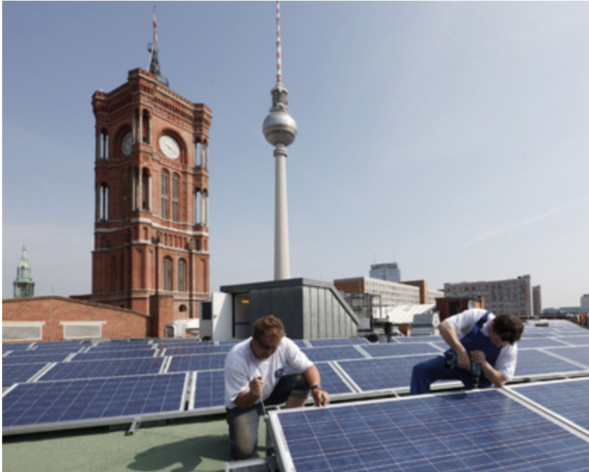
Abbildung 4 Installation der von der Berliner Energieagentur GmbH geplanten, errichteten und auch heute noch betriebenen PV-Anlage auf dem Roten Rathaus im Jahr 2010.
