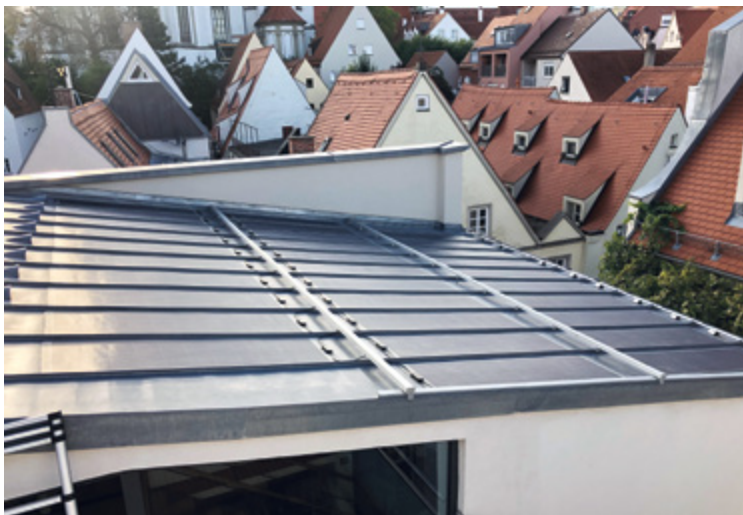
Abbildung 57 Leichte, aufgeklebte Module auf einem Metaldach.
