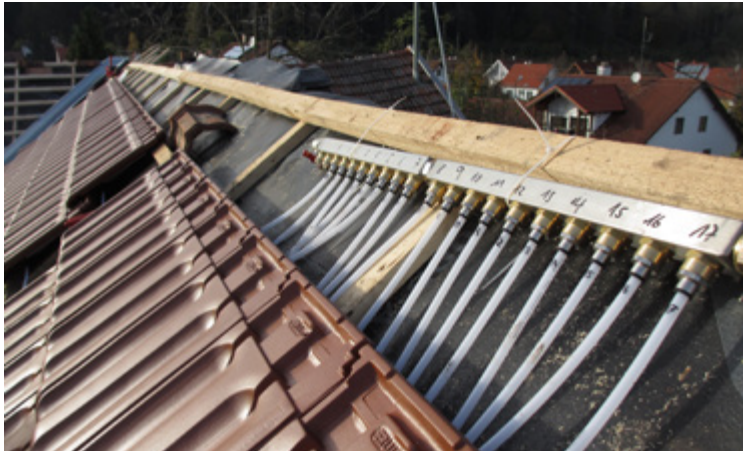
Abbildung 27 In Dachziegel integrierte Solarthermieanlage.
