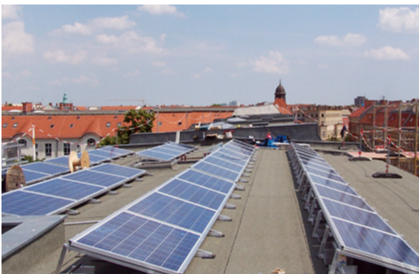
Abbildung 1 PV-Anlage auf denkmalgeschützten Objekten der Wohnungsbaugenossenschaft „Bremer Höhe“.
