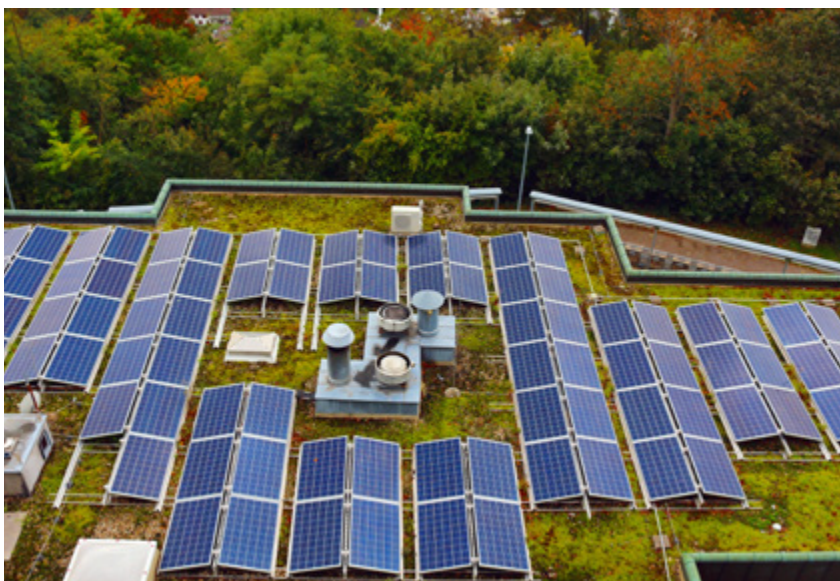
Abbildung 28 PV-Anlage auf einem Gründach.
