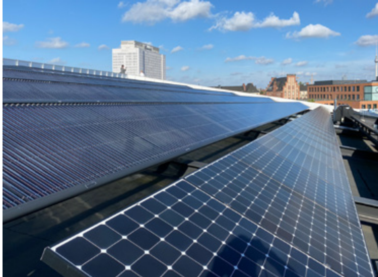
Abbildung 8 Solarthermie und Photovoltaik auf dem Dach des Futuriums.
