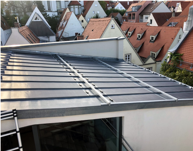
Abb. 10: Durch ein Glasfaserträgermaterial sind die Module auf diesem Metalldach besonders dünn und leicht
