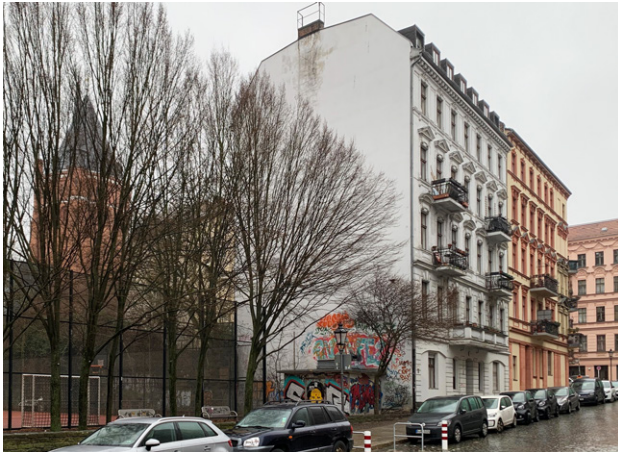
Abb. 7: Brandwand in einem Denkmalbereich
