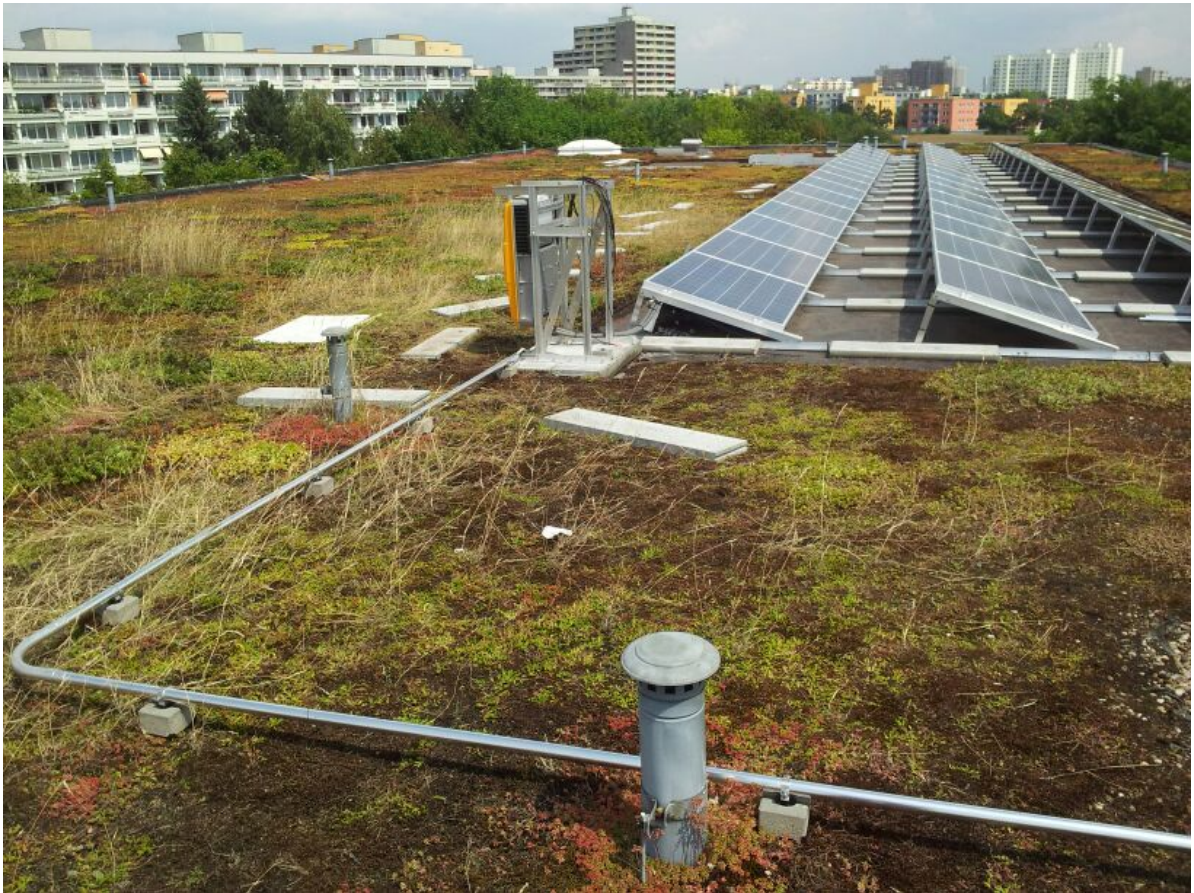
Photovoltaikanlage der Heinrich-Mann-Schule, Gerlinger Str. 22, Das Foto wurde zur Verfügung gestellt von der Heinrich-Mann-Schule ©
