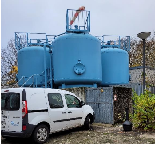
Abbildung 10 Foto der Sandfilter im Sommerbad Neukölln
