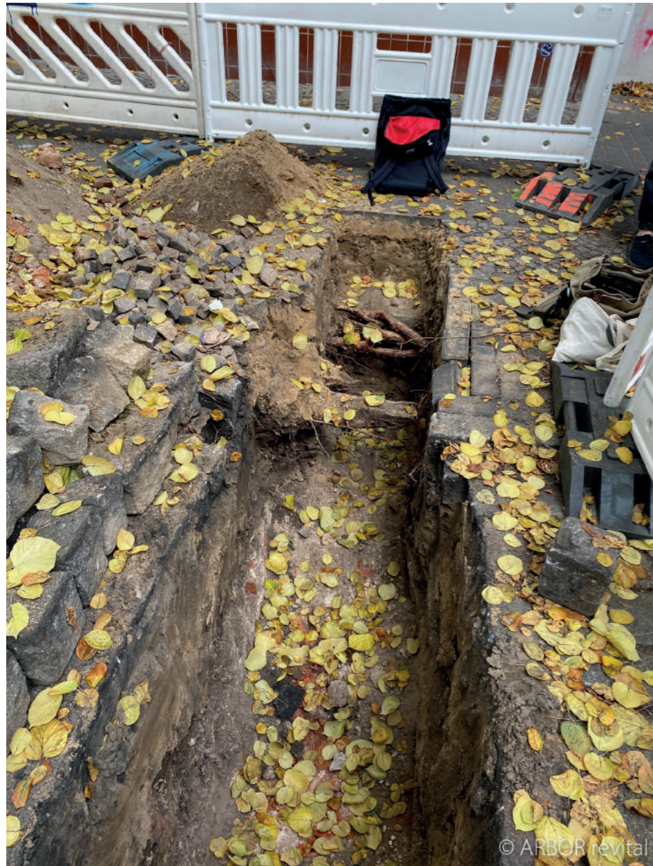
starke Wurzelstränge im Bereich des Hochbords
