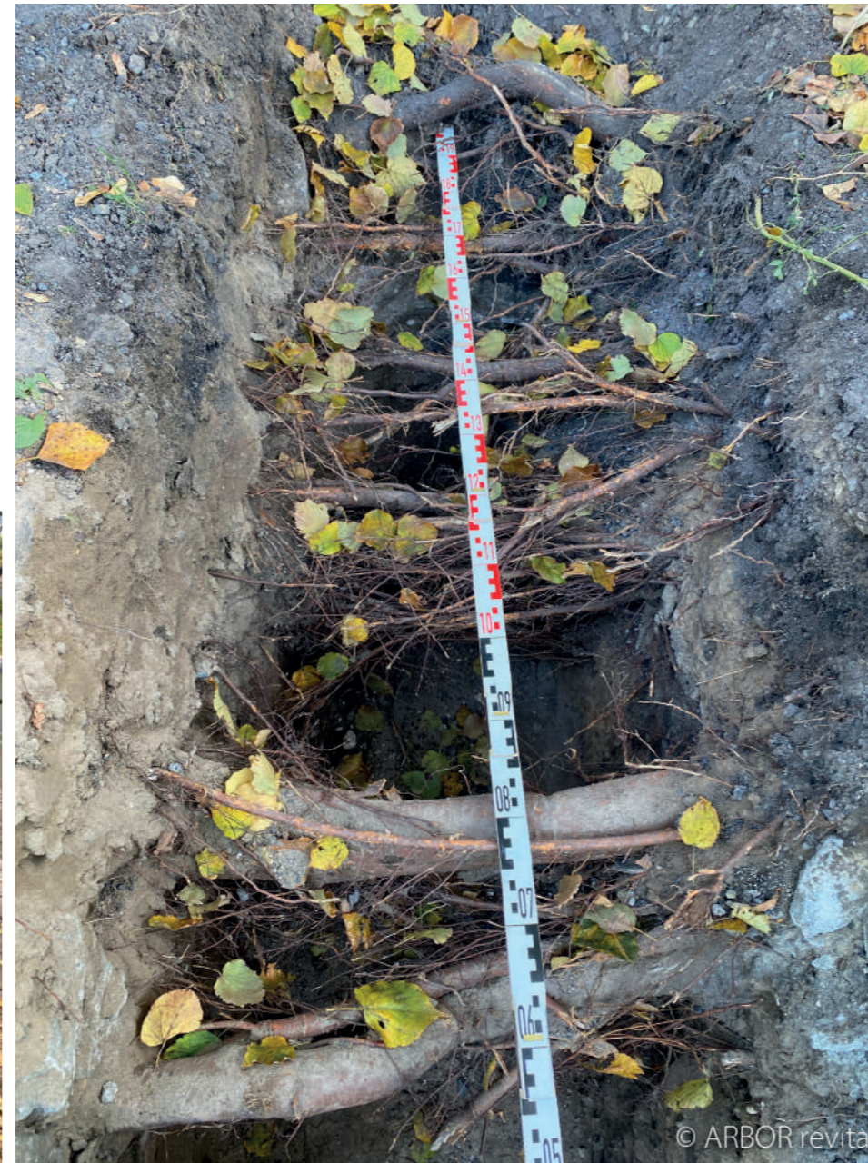
dichtes Wurzelwerk im Bereich der Baumscheibe und des Gehwegs
