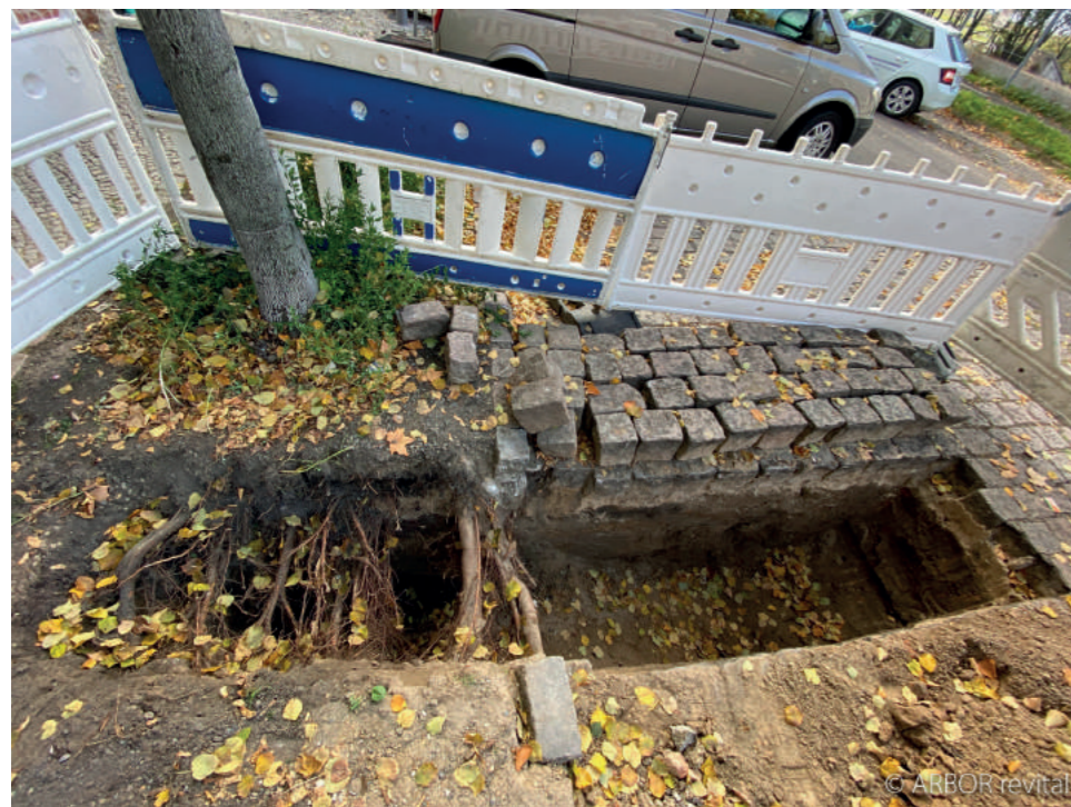
Wurzeln ausschließlich im Bereich der Baumscheibe und des Gehwegs, keinerlei Wurzelwerk unterhalb der Stellplätze
