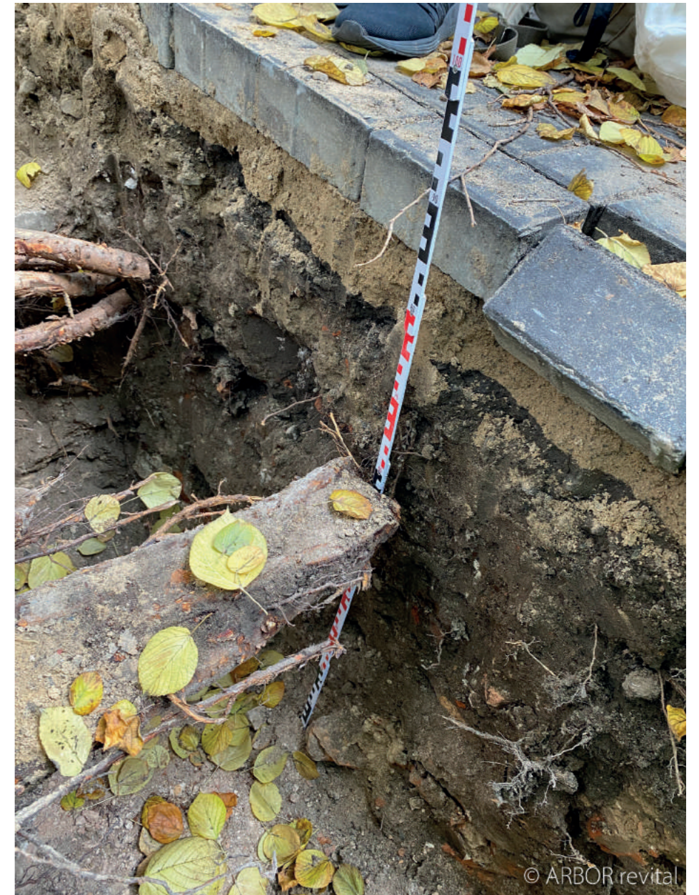
Durchtrennung großer Wurzeln durch frühere Baumaßnahme, diese sind nur zum Teil regeneriert
