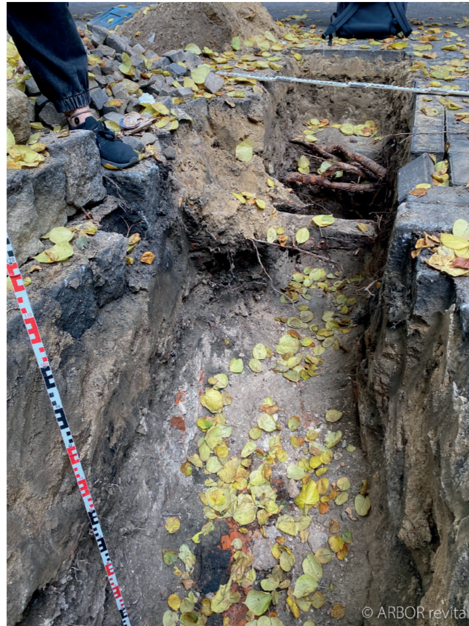
Wurzeln auch unterhalb der Fahrbahn, weil Ziegelschutt die Verdichtung des Bodens verhindert hat
