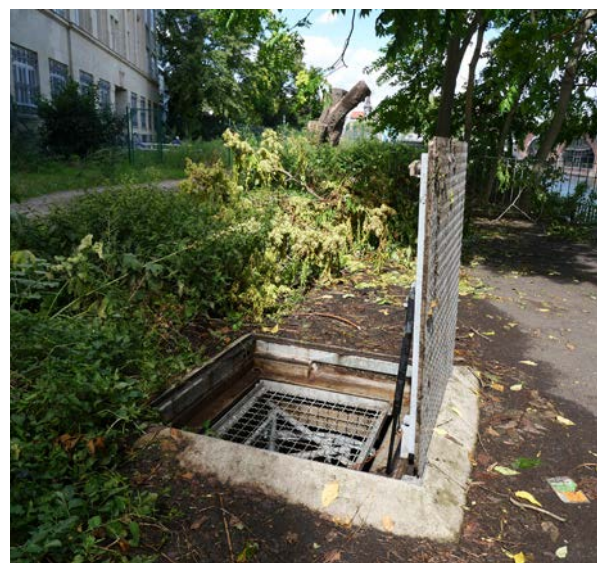
Kühlwasserauslaufbecken (Quelle: eigene Aufnahme)
