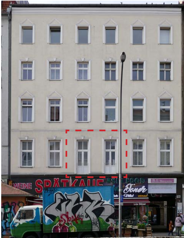
Abb.: die wahrscheinlich ehemals an der Fassade vorhandenen Balkone sind nicht mehr vorhanden
