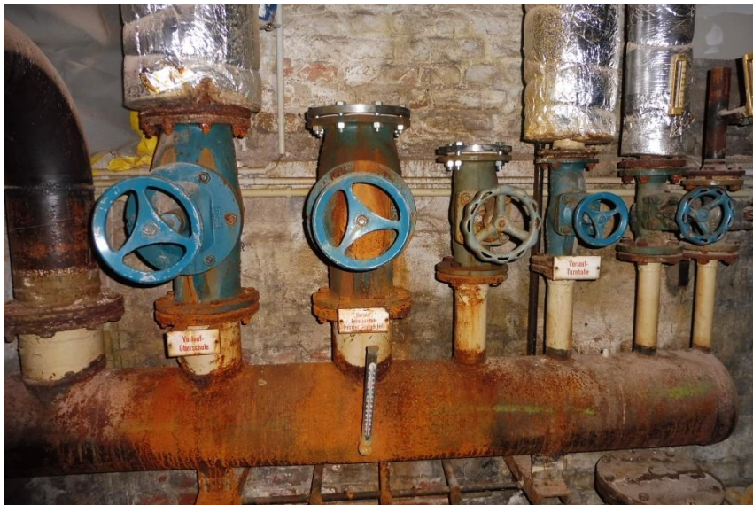
Abbildung 38: Rohre teilweise nicht gedämmt und stark korrodiert
