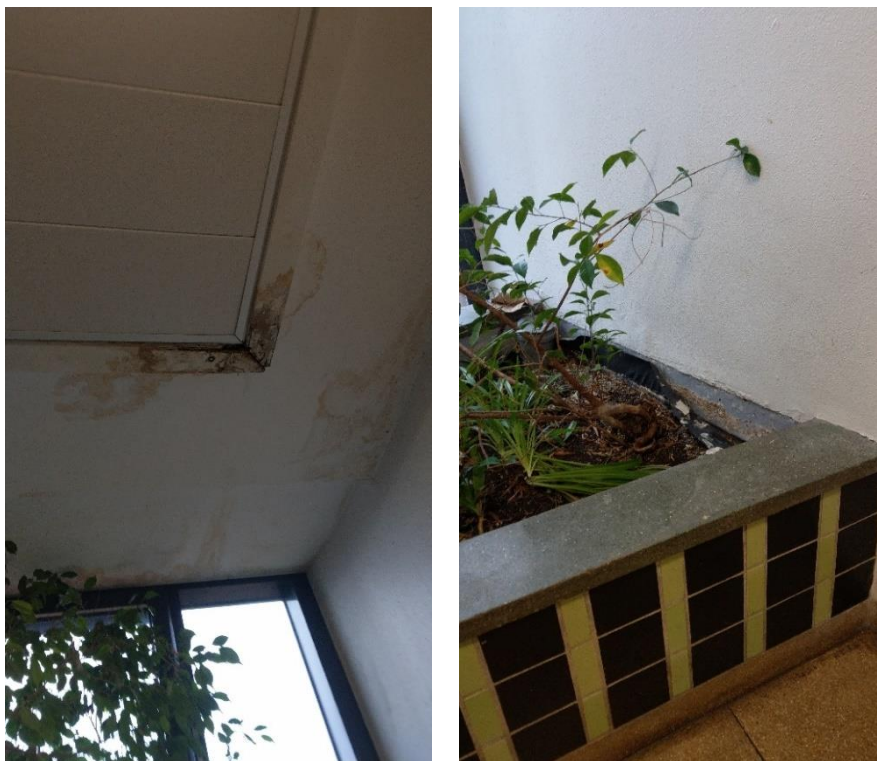
Abbildung 40: Feuchtigkeitsschäden durch Undichtigkeiten im Blumenbeet
