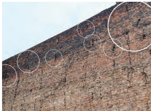
Abbildung 37: Quartiersstrukturen für Fledermäuse (weiße Markierungen) in Schadstellen an der Brandwand in der Böttgerstr. 15 (Ortlieb GmbH 2024)
