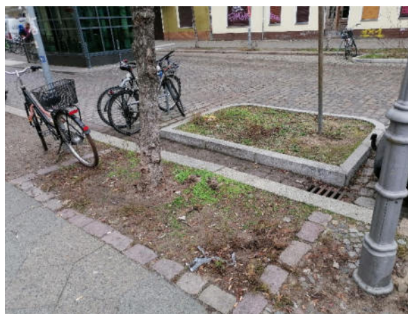
Abbildung 11: Fehlender Regenwasseranschluss in der Wilhelmshavener Straße
