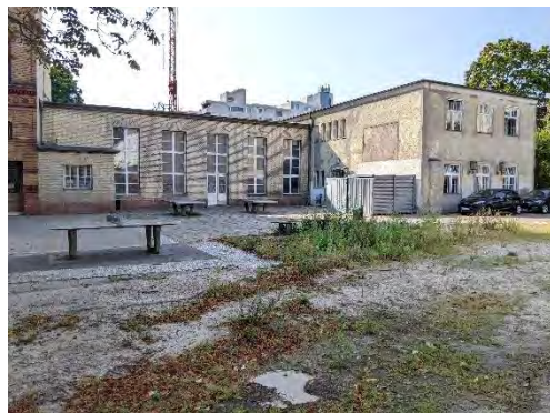
Abb. 37: Kleinsporthalle von außen und sanierungsbedürftige Außenanlagen, Quelle:
