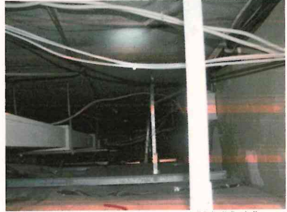
Vorhandene Elektroleitungen (Kabelbündel) in Zwischendecken notwendiger Flure, welche nicht ausschließlich der Versorgung dieser Flure dienen
