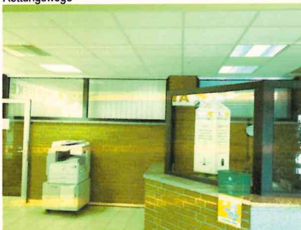
Unzulässige Brandlasten in Wartebereichen in notwendigen Fluren - Gefahr starke Verrauchung der Flucht- und Rettungswege
