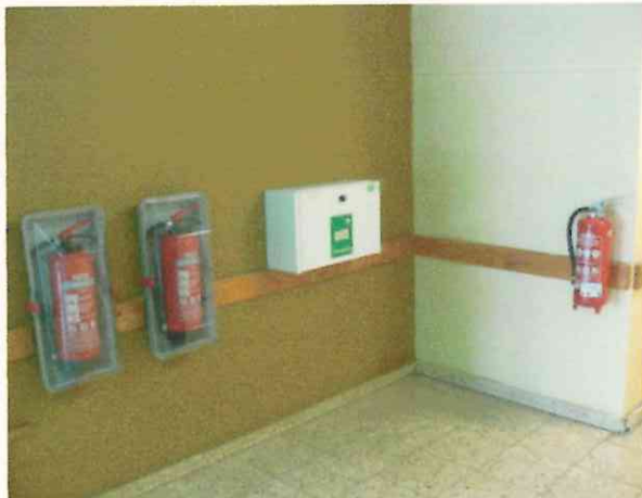
Vorhandene Feuerlöscher (ABC) im Bereich notwendiger Flur, neben Aufzug
