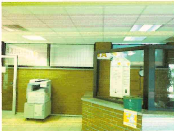
Nicht klassifizierte Oberlichter in der Treppenraumerweiterung Ausgang Süd, unzulässige Brandlast (Kopierer)
