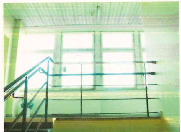
per Hand öffnbare Fenster zur Rauchableitung an oberster Stelle Treppenraum vorhanden. Fehlende automatische Öffnungsvorrichtung, bedienbar von oberster Stelle und vom Erdgeschoss aus.
