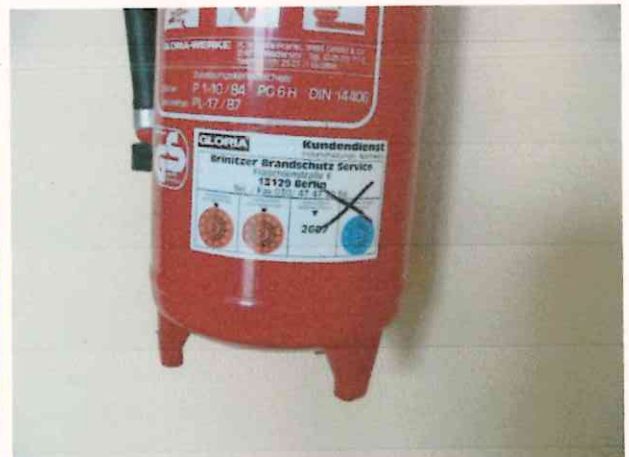
Prüffristen einzelner Feuerlöscher abgelaufen
