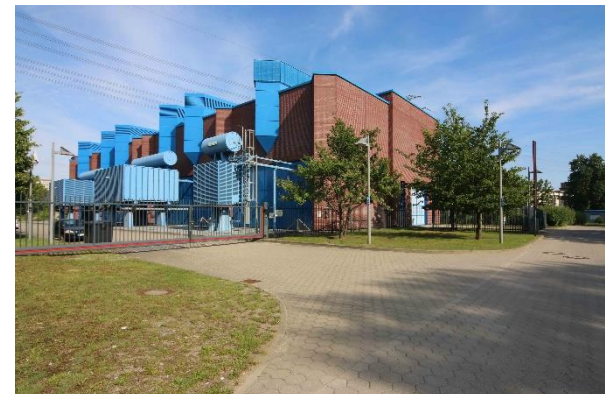
Abb. 24: Trafostation im Nordosten
