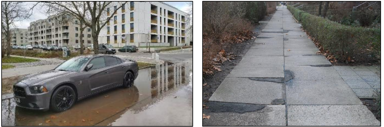
Abb. 35: Instandhaltungsmängel im Straßenraum (Fotos: Planergemeinschaft)
