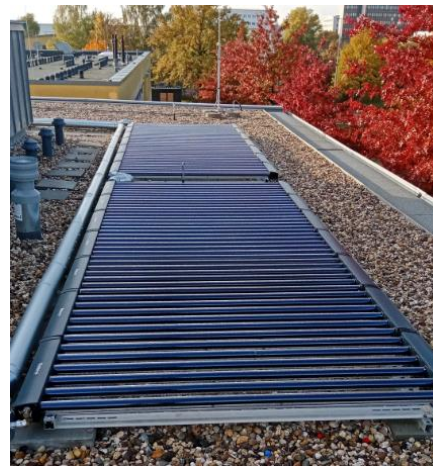
Foto 2: Solarthermieanlage auf dem Sportfunktionsgebäude Siegfriedstr. 71
