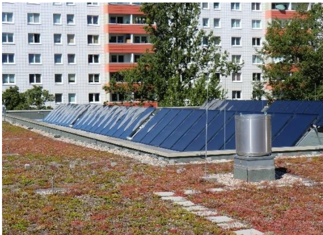
Foto 1: Solarthermieanlage auf der Nils-Holgersson-Schule
