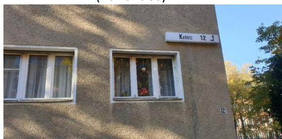
Abbildung 19: Erneuerungsbedürftige Fenster (Kahlstraße)
