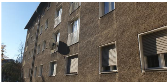
Abbildung 16: Graue Fassade, teilweise mit Schäden in der Kahlstraße
