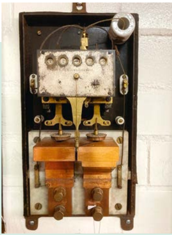
Stromzähler: Doppel-Pendelzähler Electricity meter: Dual pendulum meter
