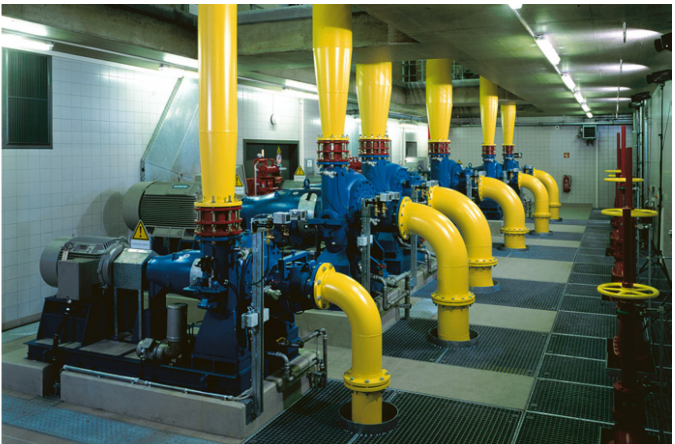
Abbildung 6.6-1 Maschinenraum des Pumpwerks Seestraße
