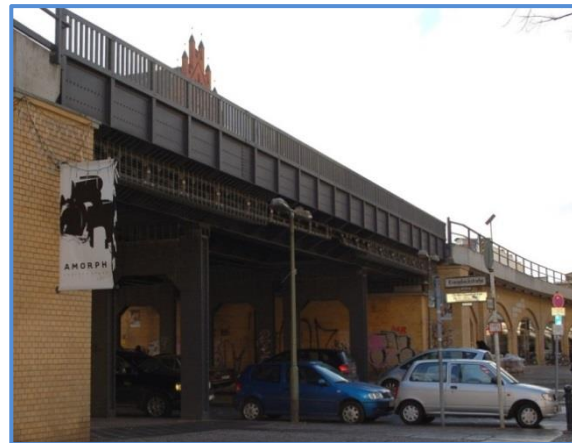
Abbildung 22: „Entdröhnte“ Brücke über die Knesebeckstraße
