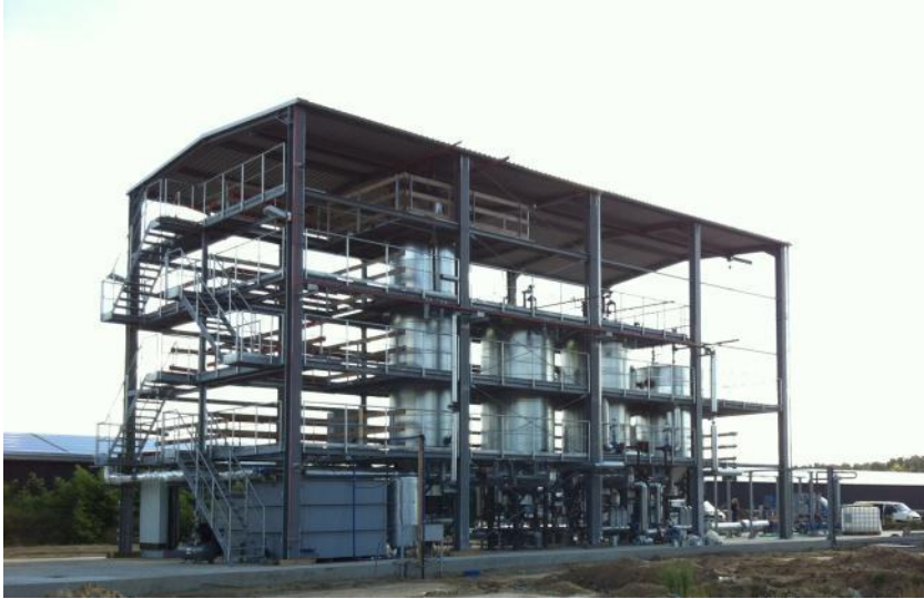
Abbildung E-5 HTC-Anlage in Relzow, Mecklenburg Vorpommern, erste Ausbaustufe (Foto: AVA-CO2)
