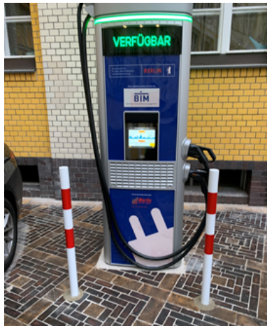
Abbildung 17: Ladesäule auf Liegenschaft im SILB
