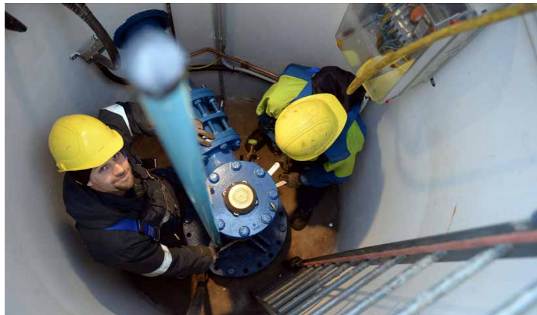
ENERWAG – Energieeinsparung in der Brunnen-Rohwassergewinnung
