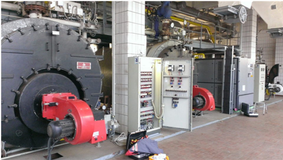
Abbildung 20: Kesselanlage im Bestand, integriertes BHKW (rechts im Bild)
