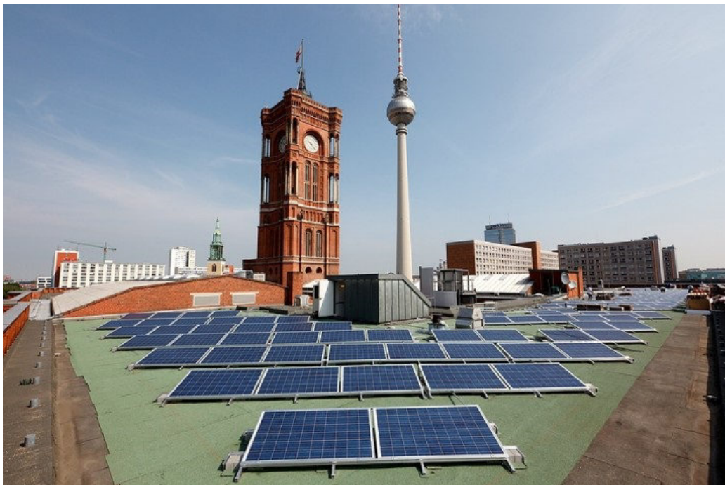
Abbildung 23: PV-Anlage auf dem Roten Rathaus
