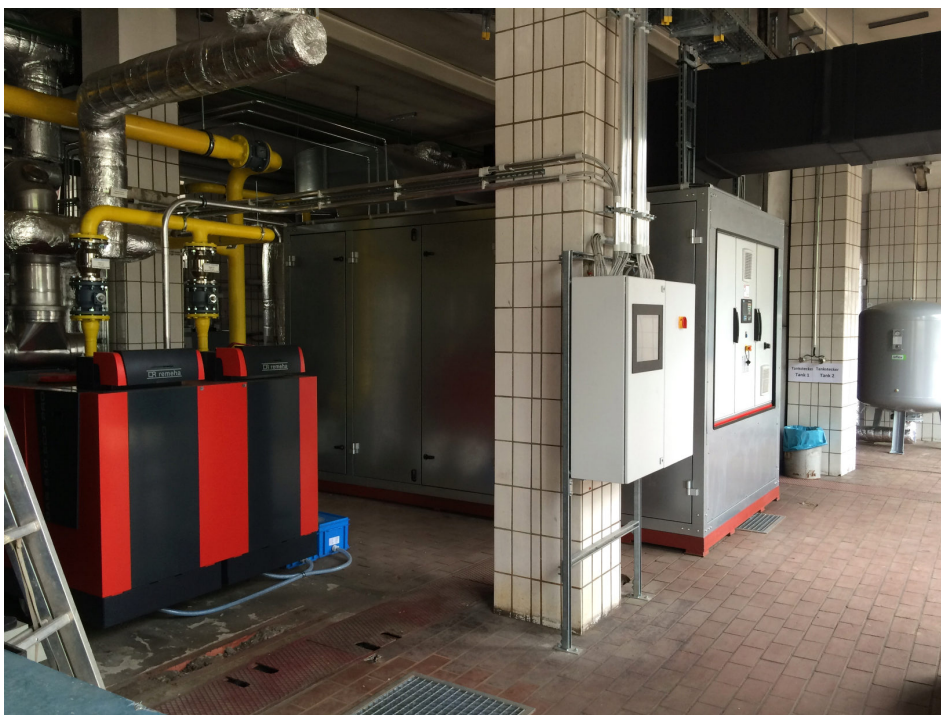
Abbildung 21: Kesselanlage mit BHKW (rechts im Bild)
