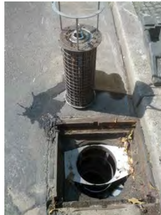
INNOLET G, Ausbau des Filter zur Wartung (UEP Berlin, Clayallee, Sieker)
