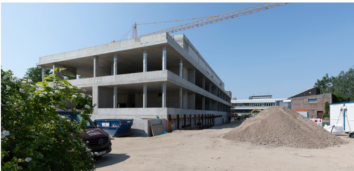
Rohbau am 19. Juni 2019, Nordwestfassade, Institut für Chemie und Biochemie im Hintergrund. Das Sockelgeschoss wird erst in Folge des Geländeabtrags sichtbar. Foto: Robert Patz
