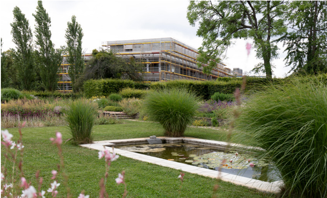
Blick auf den Rohbau vom Gelände der Königlichlichen Gartenakademie aus am 9. Juli 2019, Foto: Robert Patz
