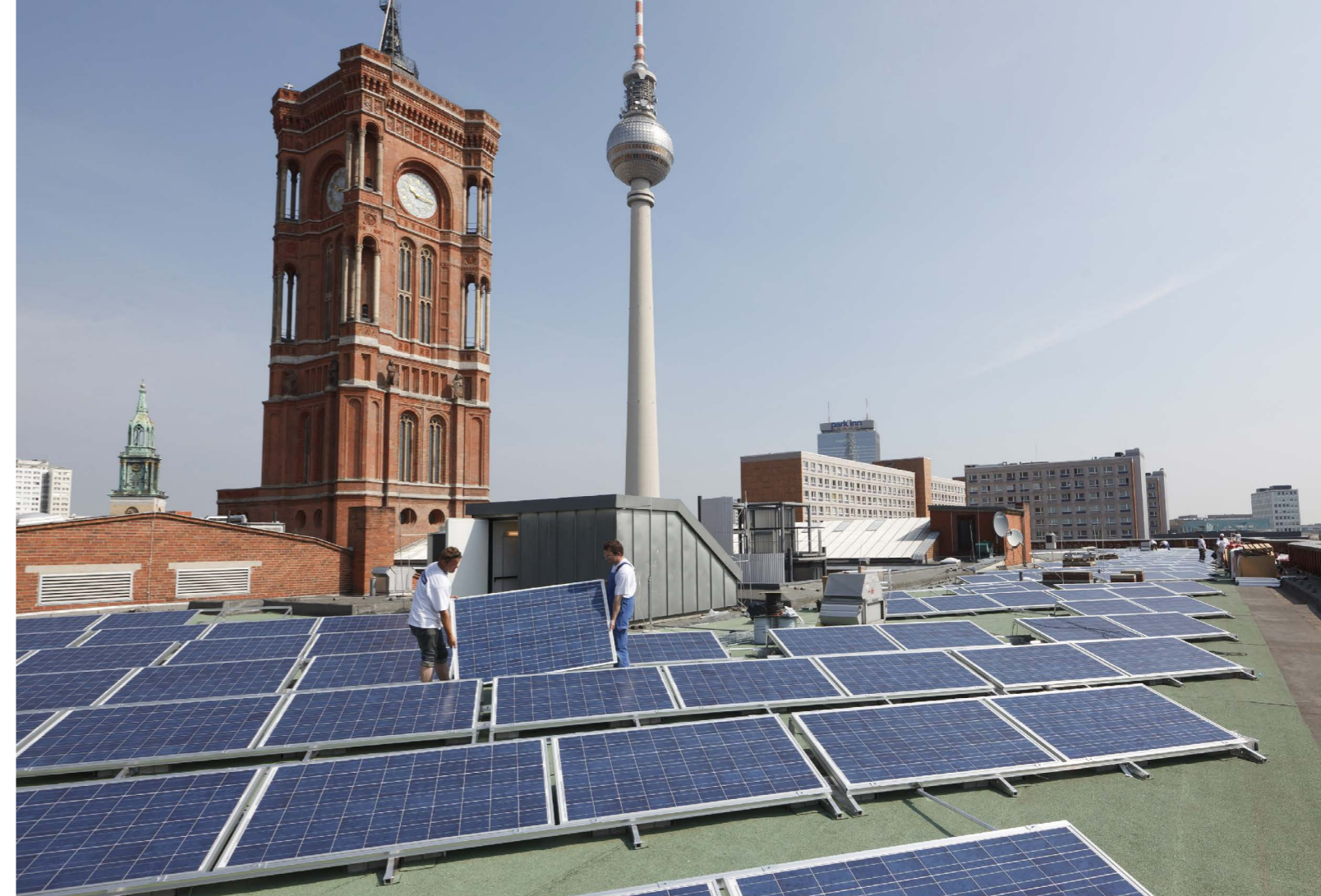
Abb. 4: Solardach auf dem Roten Rathaus Berlin (Foto: Berliner Energieagentur GmbH)
