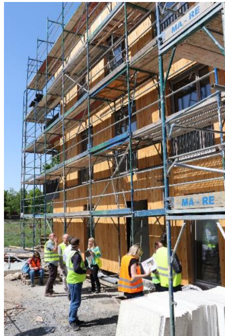
Bild 10: Sowohl die tragenden Wände als auch sämtliche Decken des Objektes in Potsdam werden in massiver Holzbauweise errichtet. Foto: Kollaxo
