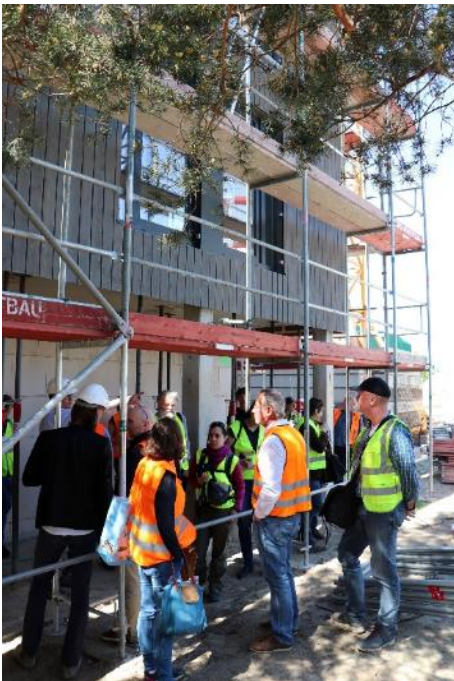
Bild 9: Vorgefertigte Holzfassaden-Elemente tragen zum schnellen Baufortschritt des Hybridbaus in Berlin-Adlershof bei. Foto: Kollaxo
